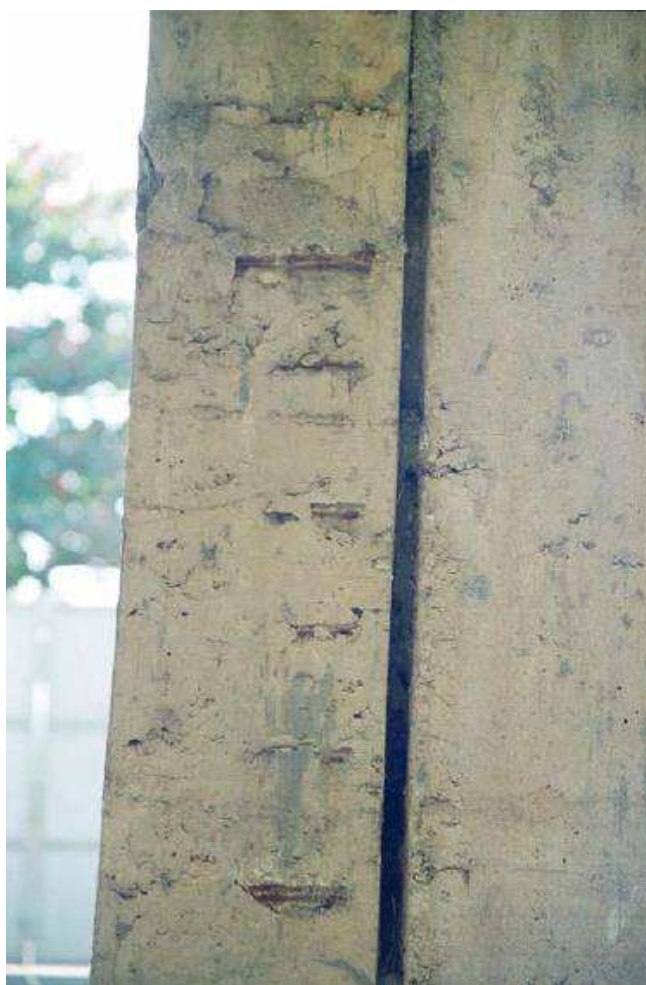
Figura 18 – Corrosão em estribos de pilar do estádio Magalhães Pinto - Mineirão (MG) inicialmente através do processo de carbonatação do concreto. (VIEIRA ANGELO, 2004).
