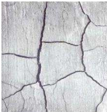
Figura 01 – Concreto com fissuras de retração.
