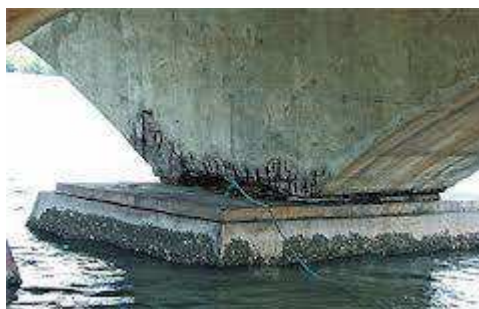
Figura 20 – Base de pilar de ponte com armadura exposta em meio de alta agressividade, provavelmente a corrosão foi causada pela ação contínua de íons cloretos.
